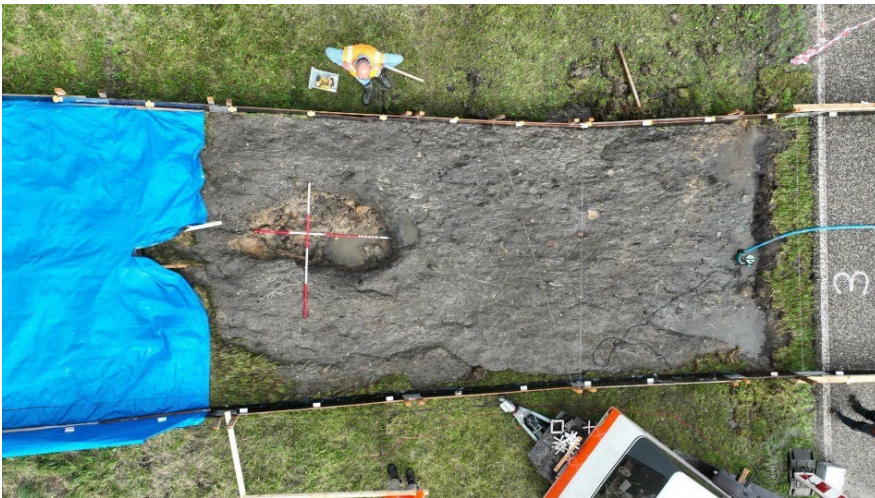
Figuur 54: Erosiegat boventalud na 0,5 uur GO100_3.2, teststrook 3.
