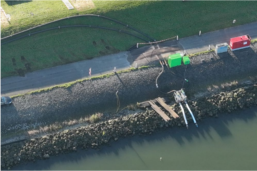
Figuur 2: Droge opstelling pompen.
