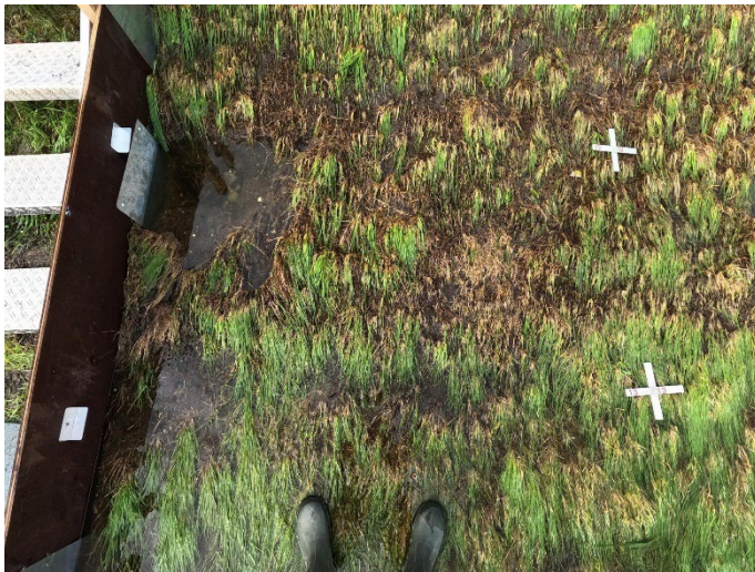
Figuur 17: Erosie in vak 13A (L75xB70xD23 cm) einde proef GO100_1, teststrook 0.
