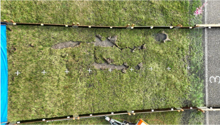
Figuur 49: Aan het einde van het eerste uur van proef GO100_1 op teststrook 3 zijn op het boventalud verschillende teruggeplaatste zoden losgekomen.
