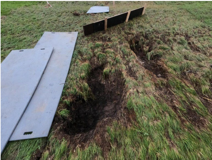
Figuur 43: Schadebeeld ondertalud na 217 volumes van proef GO100_3.2, teststrook 2.
