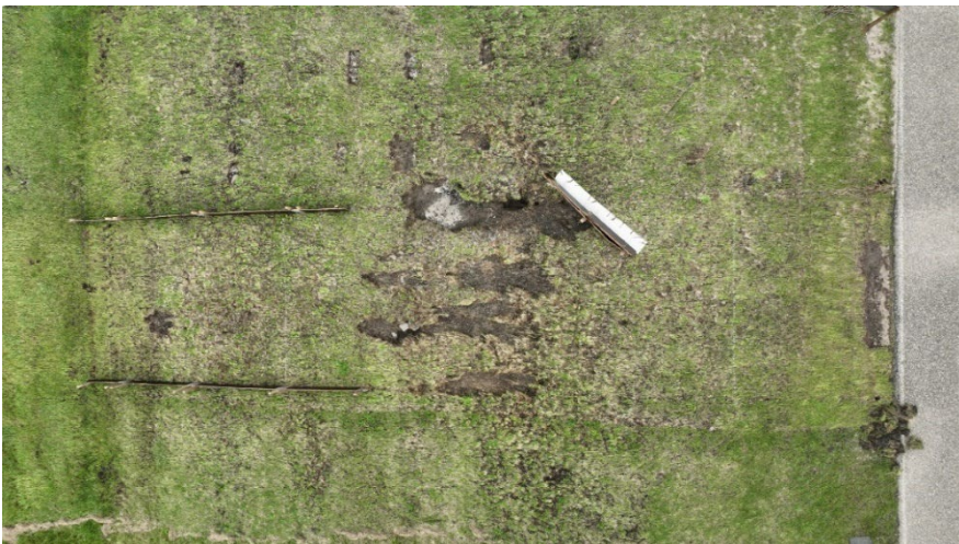
Figuur 31: Schade ondertalud einde proef GO100_3.2, teststrook 0.
