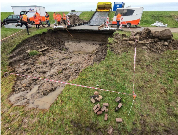
Figuur 78: Schadebeeld einde proef GO100_1, teststrook 1 (sessie 3).
