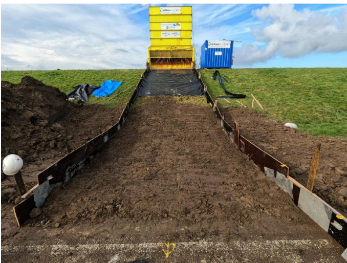
Figuur 74: Het gat ter plaatse van de geometrische overgangen weg op de binnenberm is opgevuld met grond die vrijkwam bij het maken van de klif, teststrook 1 (sessie 3).
