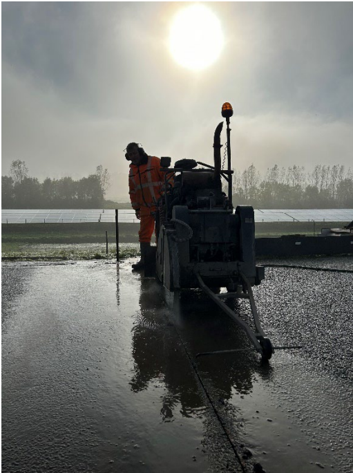
Figuur 72: Doorzagen asfalt op de binnenberm ten behoeven van kliferosieproef, teststrook 1 (sessie 3).
