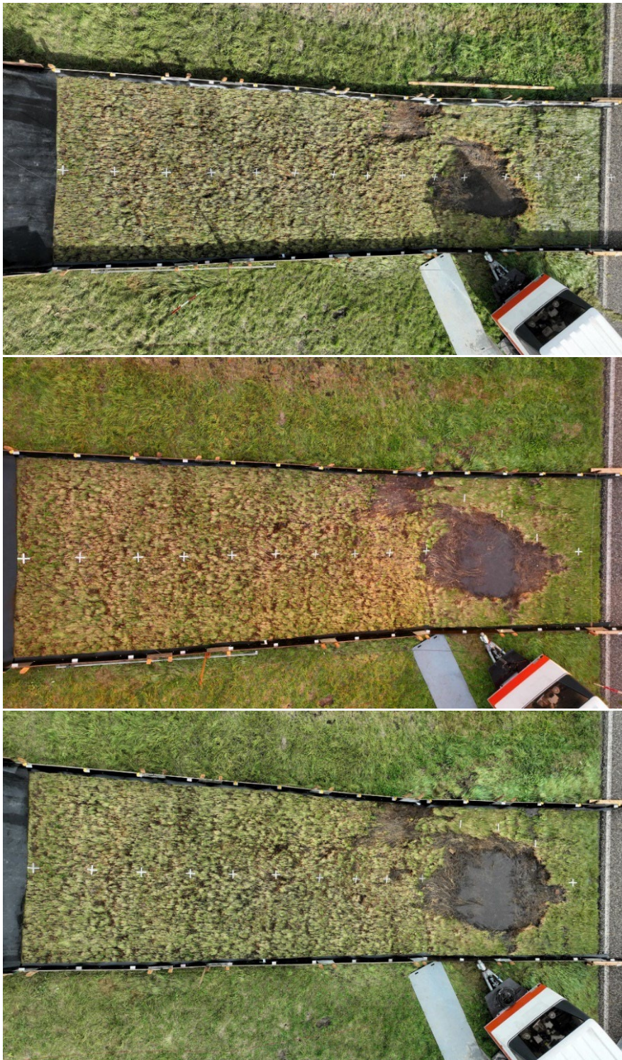
Figuur 64: Schades op het boventalud en ter hoogte van de geometrische overgang na 2 uur (boven), 4 uur (midden) en einde (onder) proef GO100_3.2, teststrook 4.
