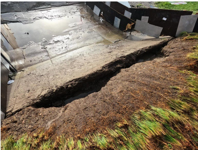
Figuur 70: Schade ter plaatse van overgang gras-Novocrete® op het boventalud einde herhaling proef GO100_3.2, teststrook 1 (sessie 2)
