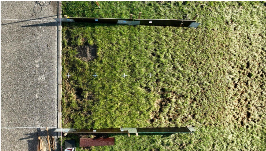
Figuur 58: Schadebeeld ter hoogte van de opsluitband einde GO100_3.2, teststrook 3.
