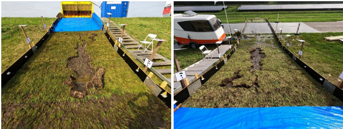
Figuur 37: Schadebeeld boventalud na 50 golven proef GO10_1, teststrook 2.
