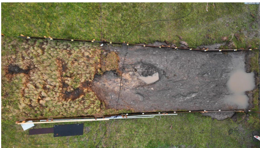
Figuur 56: Schadebeeld boventalud einde GO100_3.2, teststrook 3.
