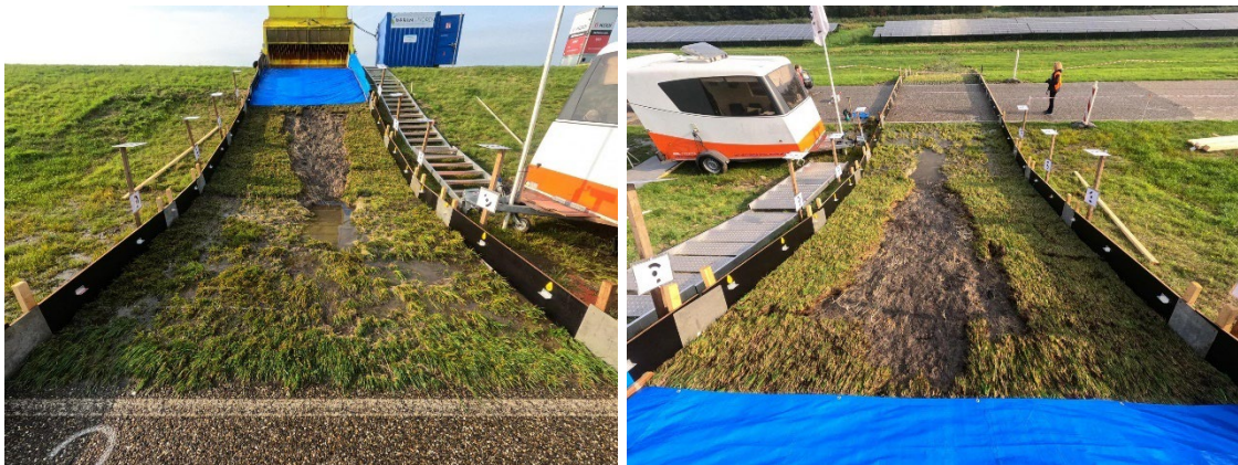
Figuur 38: Schadebeeld boventalud einde proef GO10_1, teststrook 2.
