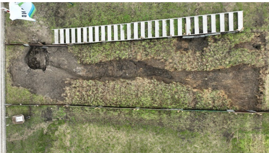
Figuur 29: Bovenaanzicht schade boventalud einde proef GO100_3.2, teststrook 0.
