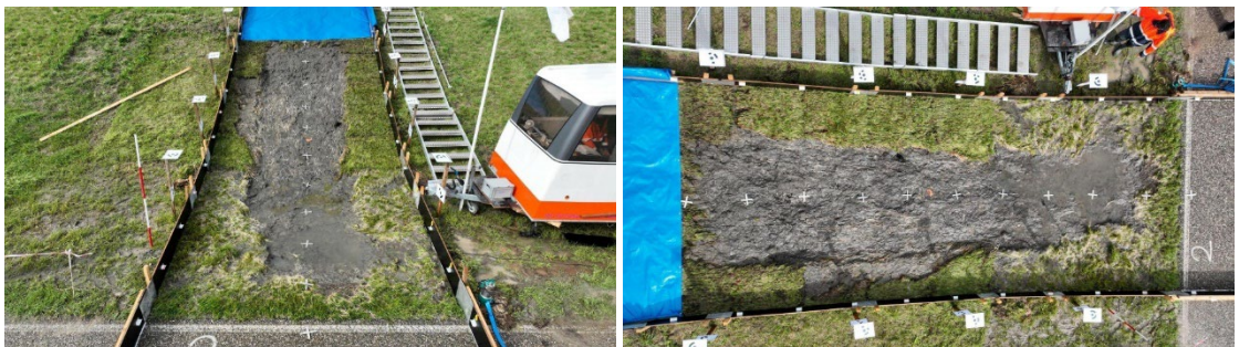
Figuur 39: Schadebeeld boventalud einde proef GO100_1, teststrook 2.
