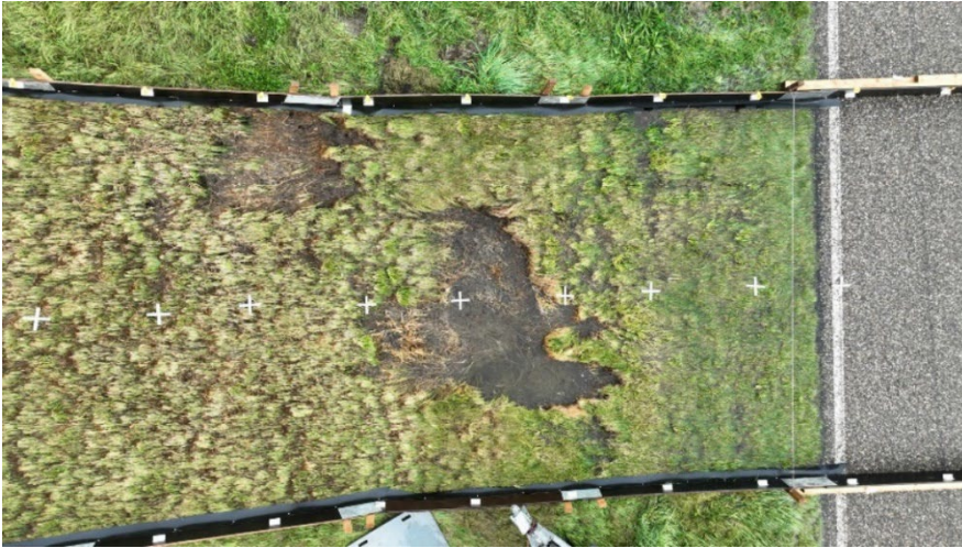
Figuur 61: Schades op het boventalud en ter hoogte van de geometrische overgang einde proef GO50_3.2, teststrook 4.
