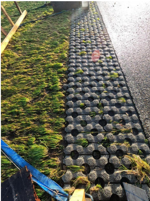
Figuur 45: Lichte slijtage achter de bermverbandblokken na alle proeven op teststrook 2.
