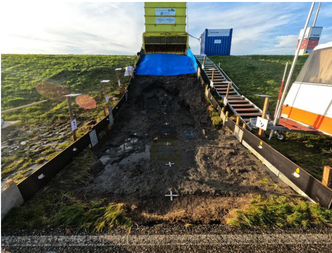
Figuur 44: Erosiekuil op het boventalud einde proef GO100_3.2, teststrook 2.
